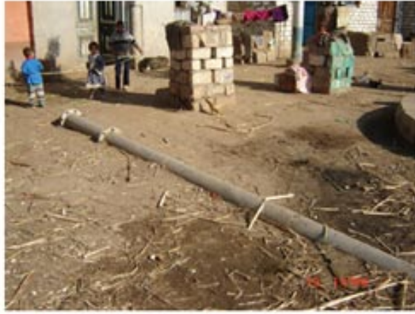
لقطة لمسورة مياه رئيسية في إحدى شوارع القرية
